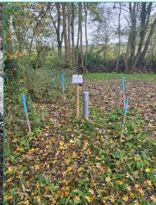
Piézomètre relié à un boîtier électrique
