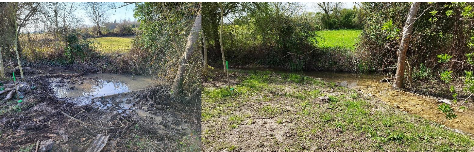
Seuil obstruant la continuité avant les travaux
